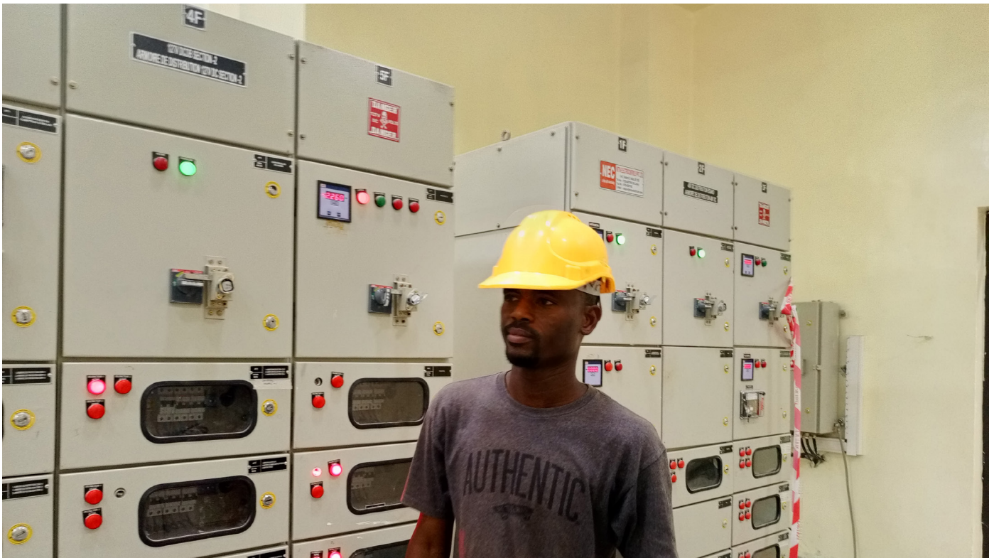
Le poste de transformation de Sanankoroba en construction dans le cadre du PIEGM
